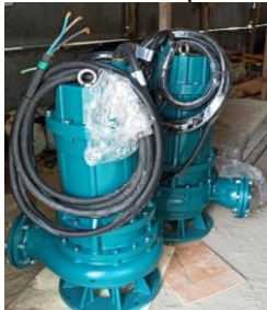
Figura 8. Suministro de bombas sumergibles
